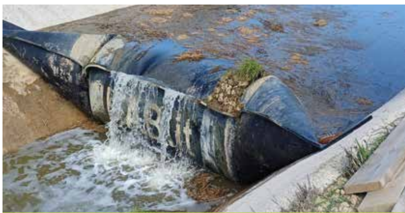
Un particolare di una delle due dighe mobili installate ad Alberese
